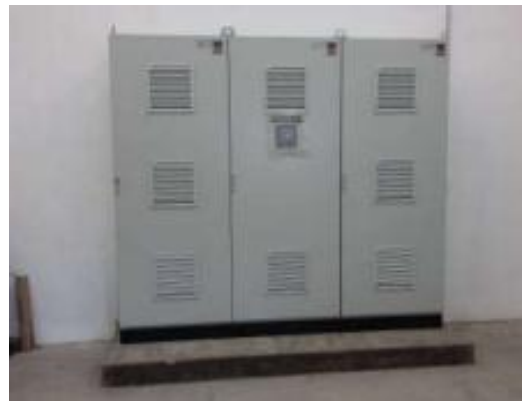
Instalación de banco de capacitores de 660 kvar.
